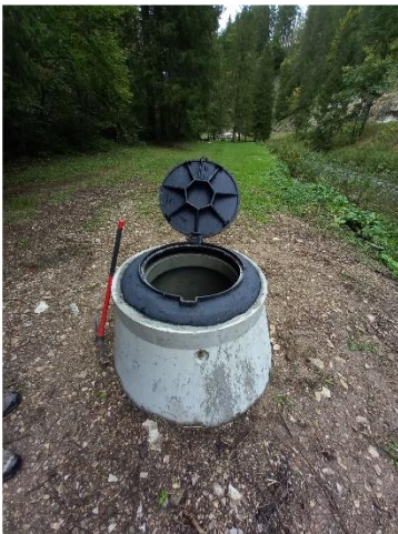
Reprise regard d'assainissement Gorges du Méaudret
