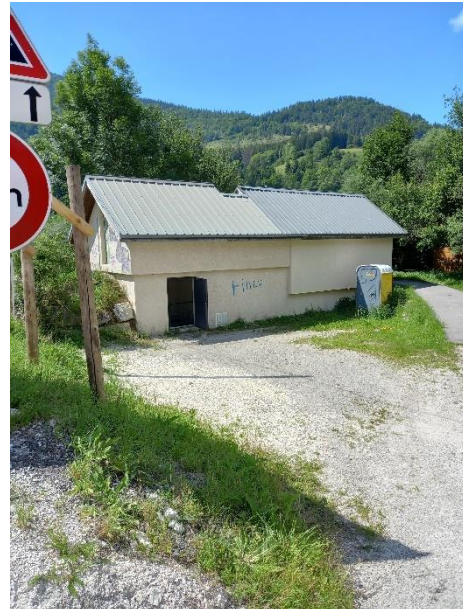
Poste de relevage des Jarrands
